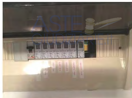
Quadro elettrico interrato
