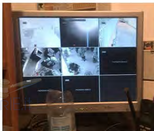
Impianto di video sorveglianza
