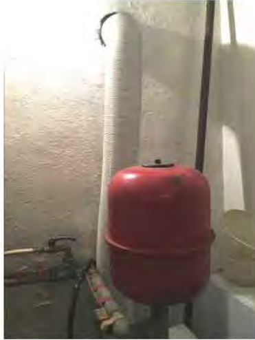
Canna fumaria e vaso di espansione
