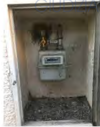
Vano contatore gas metano 2
