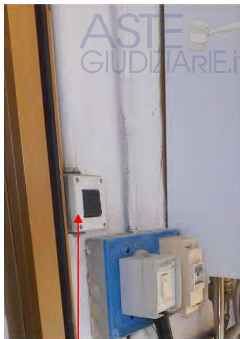
Impianto terrazzo chiuso
