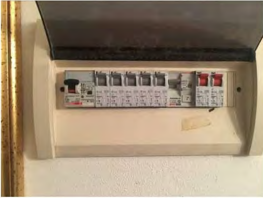
Quadro elettrico locali espositivi piano primo
