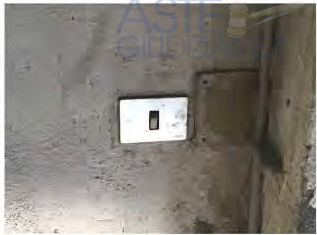
Comando elettrico interno
