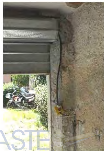
Impianto autorimessa in corrugato
