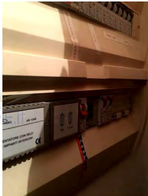
Quadro elettrico principale locali espositivi piano terra
