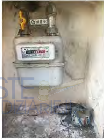
Vano contatore gas metano 1
