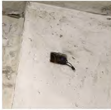
Scatola di derivazione magazzino
