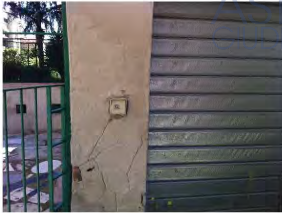
Saracinesca autorimessa con comando elettrico esterno
