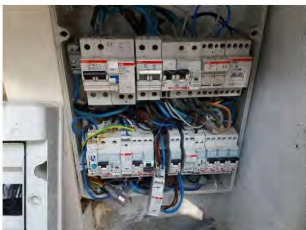
Quadro elettrico principale
