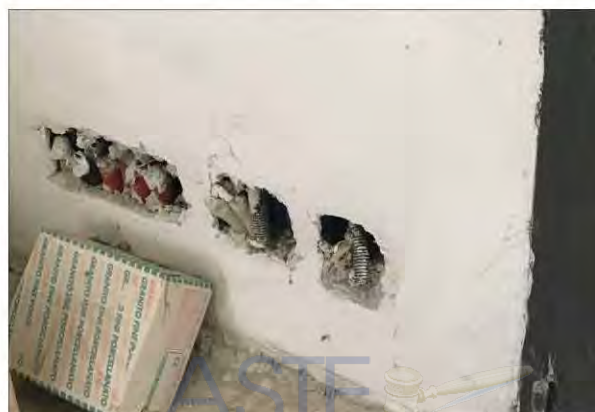
Scatole elettriche prive di fili nella parte condominiale - piano terra
