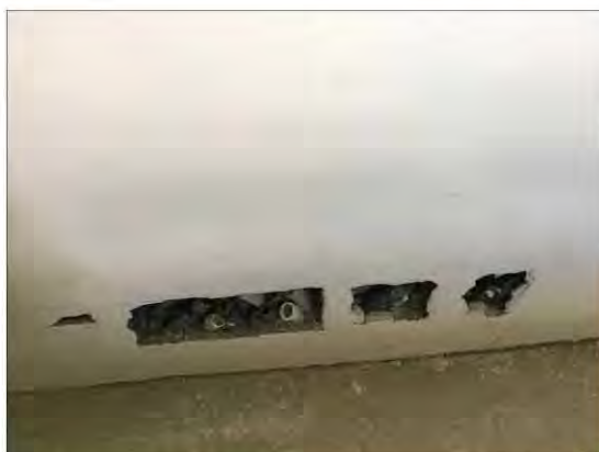
Scatole elettriche prive di fili nella parte condominiale - piano primo
