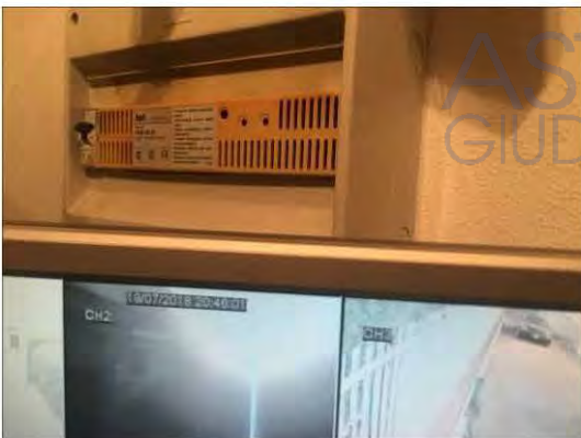
Quadro elettrico secondario locali espositivi piano terra
