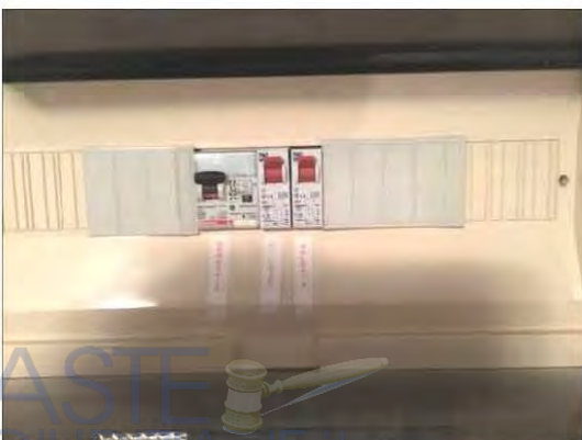
Quadro elettrico interrato
