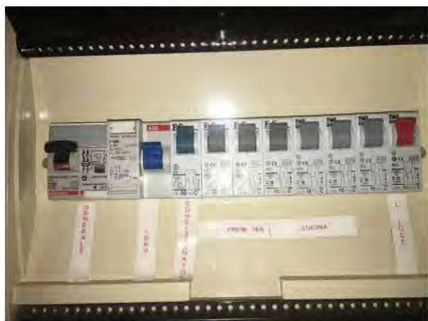
Quadro elettrico appartamento
