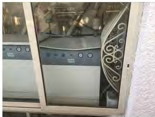
Caldaie a metano
