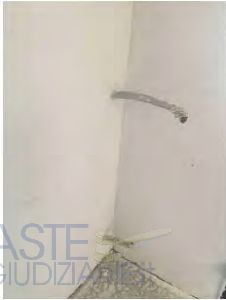
Tubazioni per radiatore
