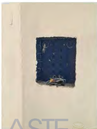
Quadro elettrico (solo scatola e fili)
