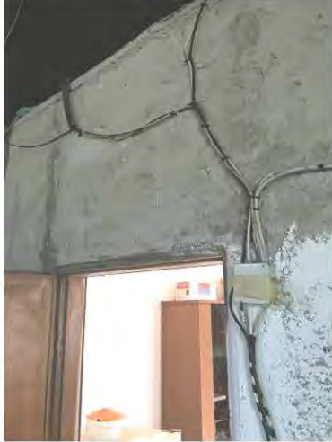
Cavi "esterni" impianto
