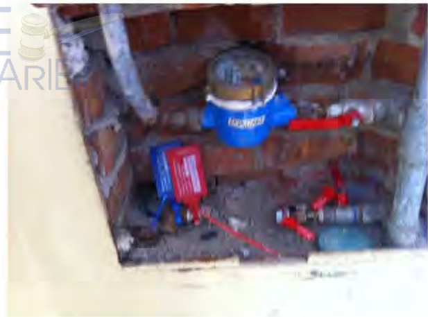
Vano contatore magazzino privo di contatore di misura
