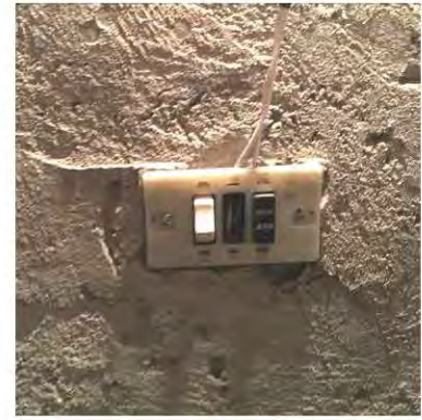
Interruttore e prese magazzino
