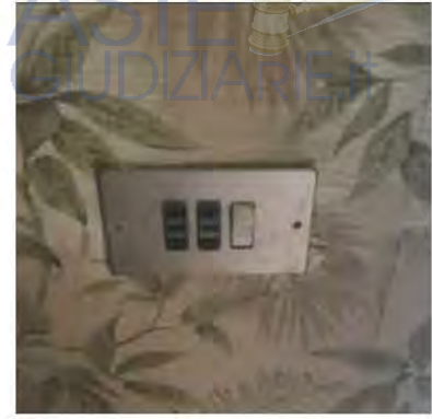
Interruttore e prese appartamento
