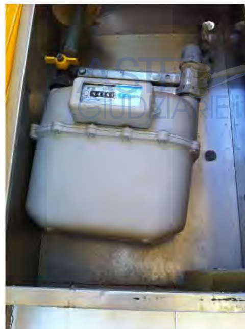
Contatore di misura gas metano
