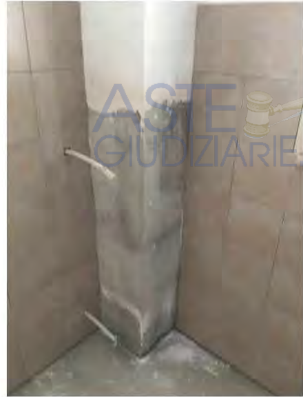
Tubazioni per radiatore: bagno dep. occasionale
