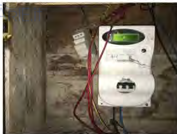
Contatore di misura e quadro elettrico principale
