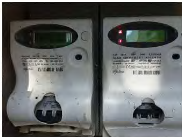
Contatori Enel abitazione e locali artigianali
