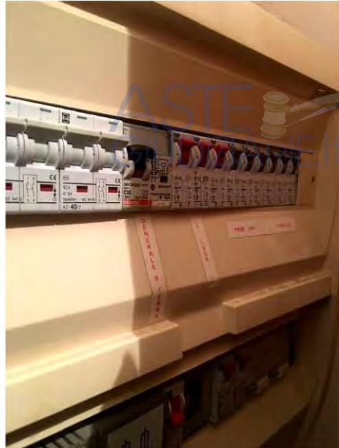
Quadro elettrico principale locali espositivi piano terra
