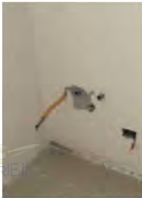
Tubazione gas cucina
