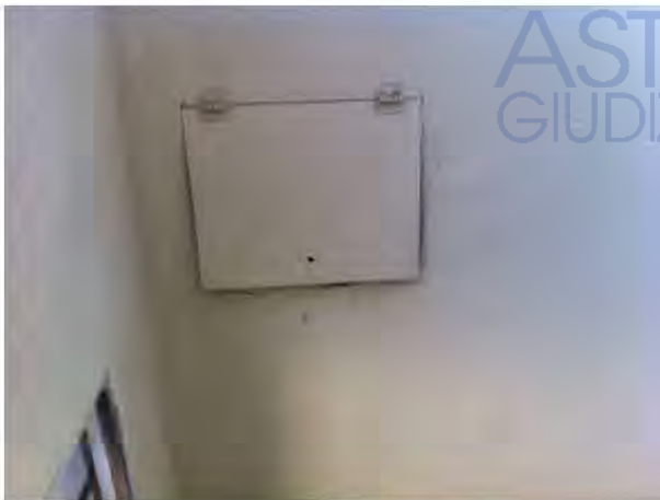
Vano contatore acquedotto
