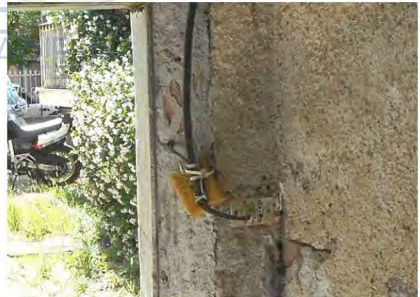
Comando elettrico interno
