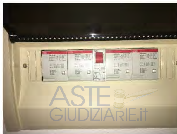
Quadro elettrico appartamento
