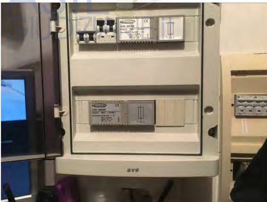
Quadro elettrico secondario locali espositivi piano terra
