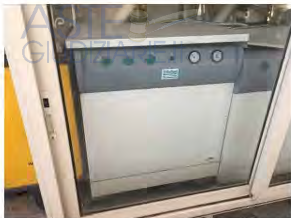
Caldaie a metano
