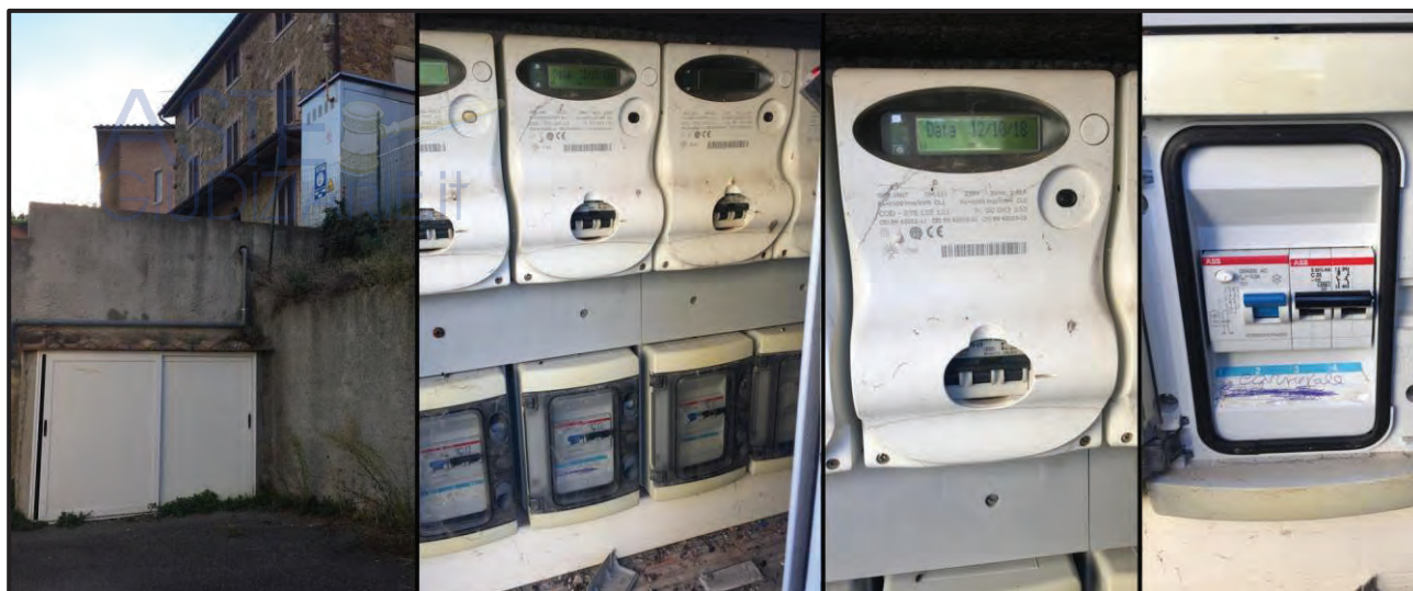
Impianto elettrico: punto di fornitura, contatore e differenziali
