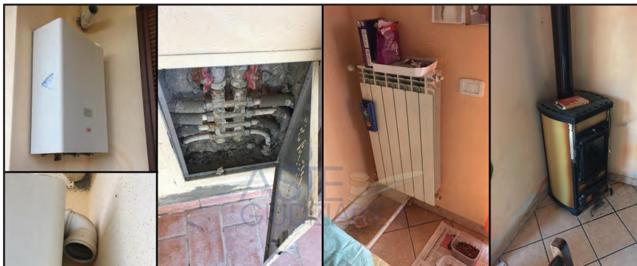
Riscaldamento: caldaia, vano clarini e radiatore; stufa in alluminio
