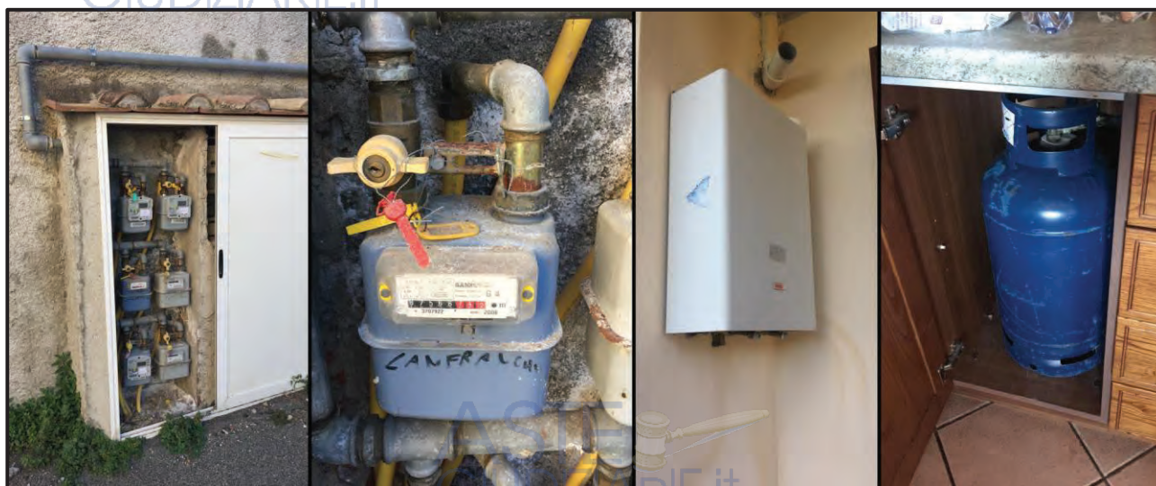
Impianto gas: punto di fornitura, contatore, caldaia, e bombolo GPL per cottura cibi.
