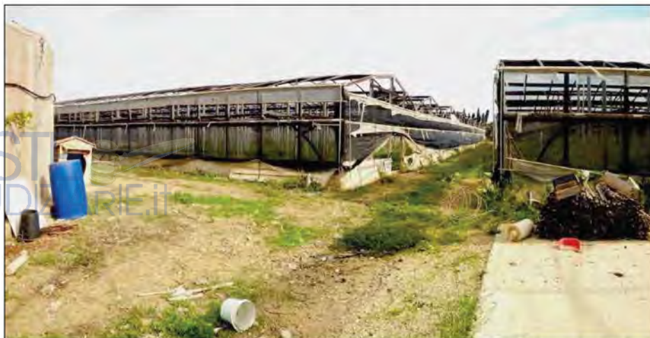
(F) - vista esterna Serre a padiglione in struttura mista (ubicate sull'area nord della part.IIa 50)
