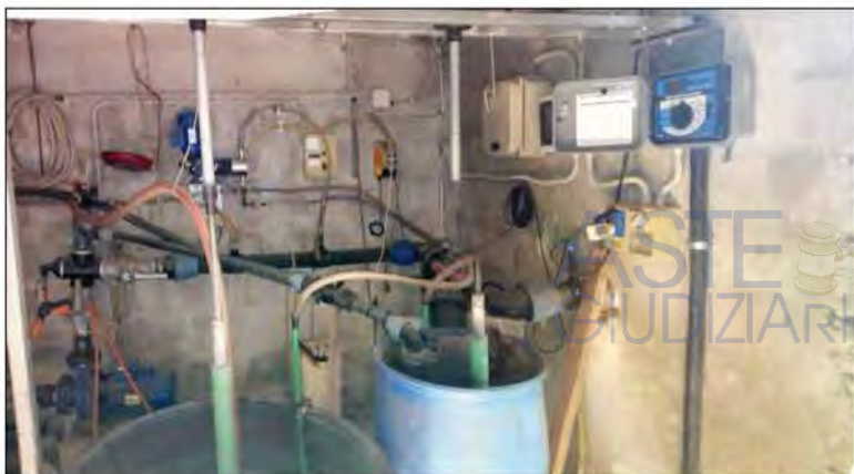
(B) - vista interna - Locale pompa con apparecchiature di automatizzazione dell'impianto d'irrigazione
