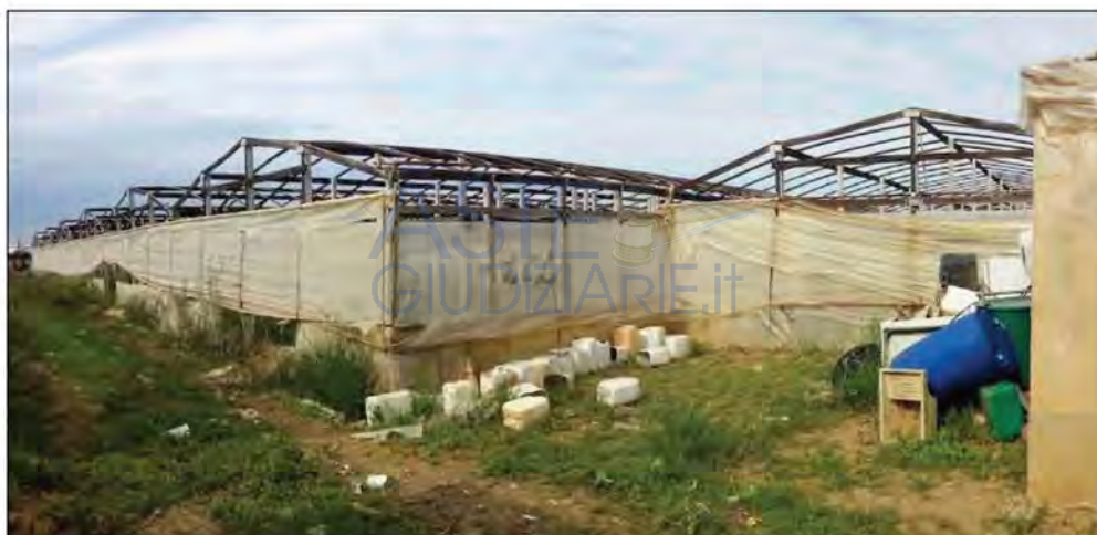
(F) - vista esterna Serre a padiglione in struttura mista (ubicate sull'area sud della part.IIa 50)
