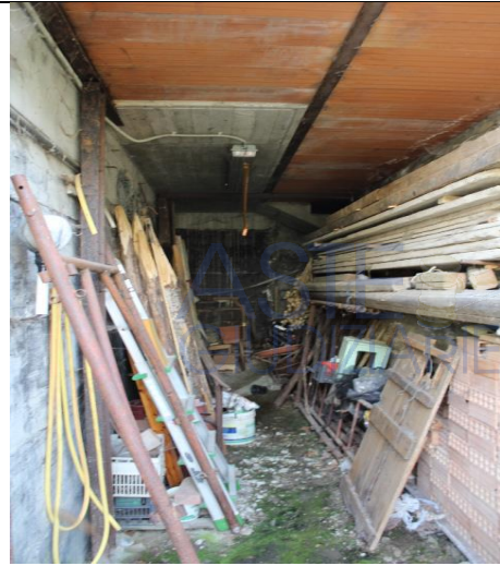
CAVEDIO NON REGOLARE. SI NOTA LA PORZIONE REGOLARE DI BALCONE AVENTE FINITURA FACCIA A VISTA
