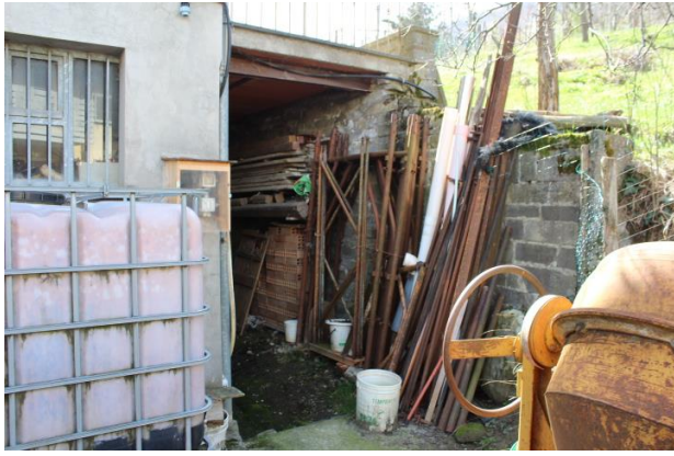
CAVEDIO AL PIANO TERRA, NON REGOLARE DA METTERE IN PRISTINO MEDIANTE DEMOLIZIONE
