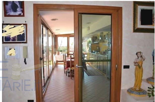
Vista degli infissi esterni non autorizzati
