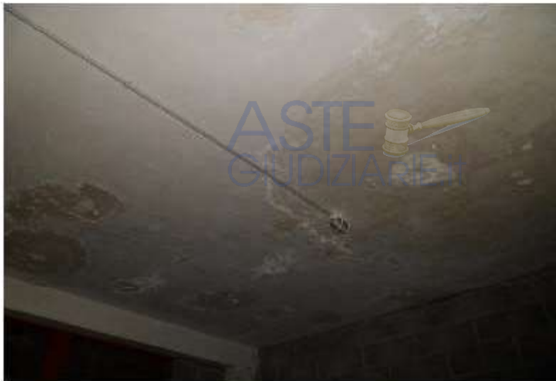
Foto n°6--Garage sub 66 stato di fatto del soffitto
