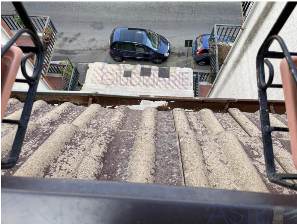
Stato delle grondaie
