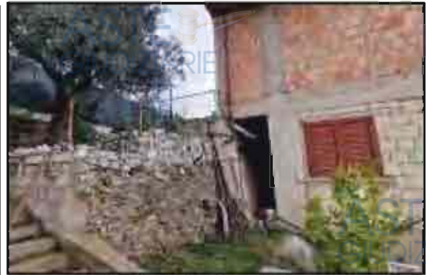
Fig. n.21 – Stato attuale muro
