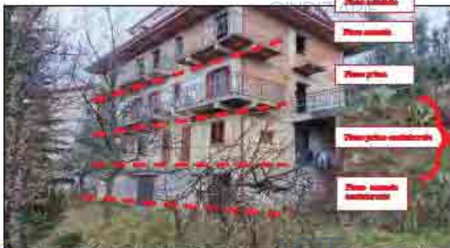
Fig. n. 3 - Foto del fabbricato in cui ricade la porzione immobiliare oggetto di pignoramento della parte oggetto rispetto alla Pto Roma (Prospetto Sud - Ovest)
