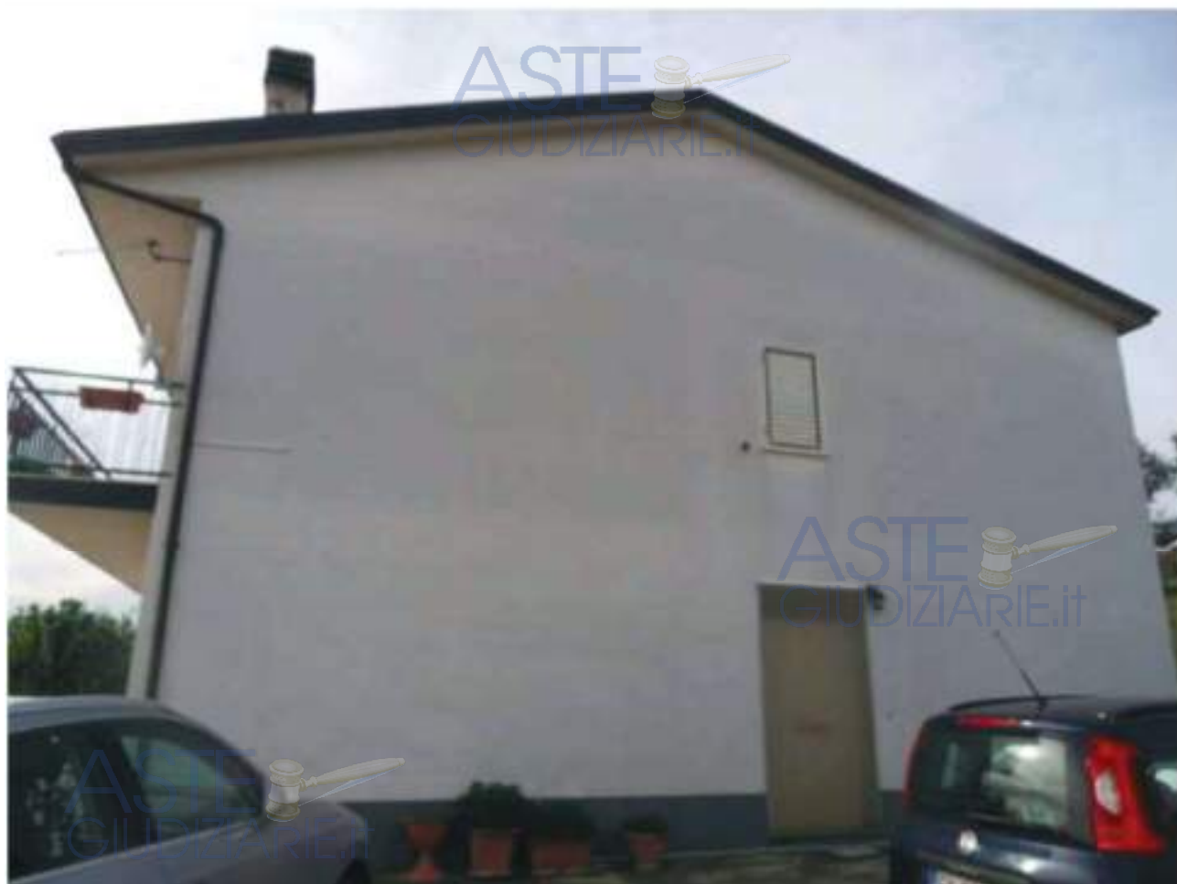
Publicazione ufficiale ad uso esclusivo personale - è vietata ogni FOTO N. 12: Prospetto NORD - EST Bene N. 1 riproduzione o pubblicazione a scopo commerciale - Aut. Min. Giustizia PDG 21/07/2009
