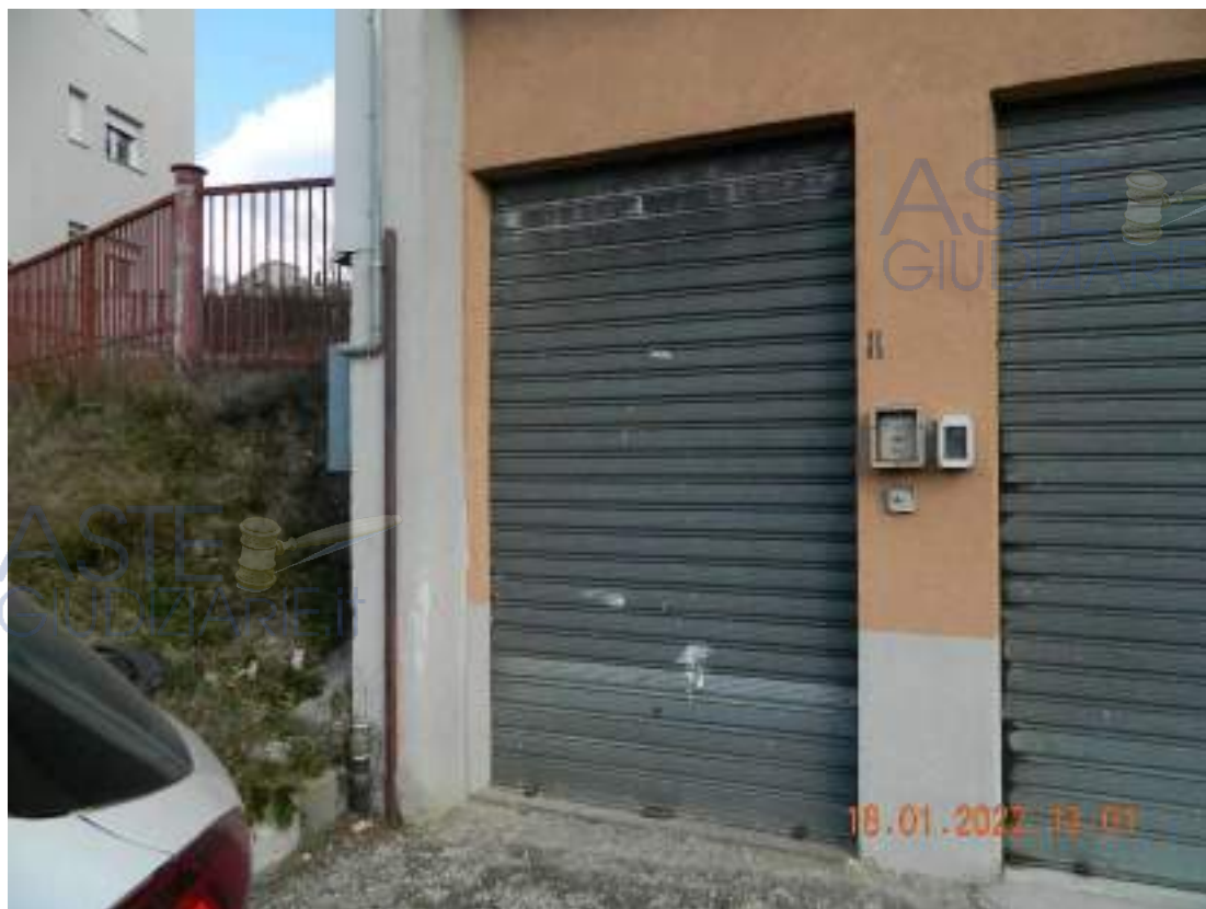
Ingresso locale caldaia al servizio dell'unità p.lla 451 sub 34
