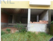
Foto n. 6 apertura non realizzata
