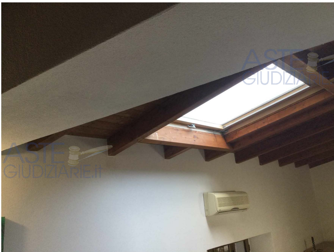
Vista del lucernario della cucina e della pompa di calore presente
