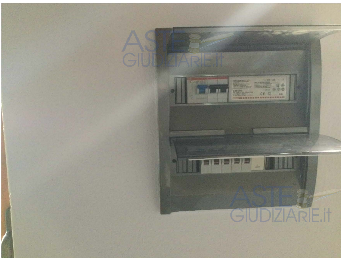
Quadro elettrico generale
