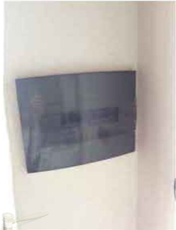
Figura 50. Quadro elettrico interno
