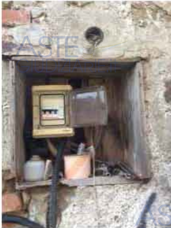
Figura 49. Quadro elettrico esterno
