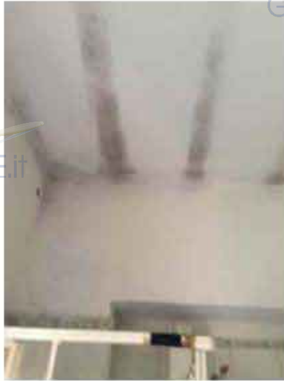
Figura 42. Soffitto del bagno
