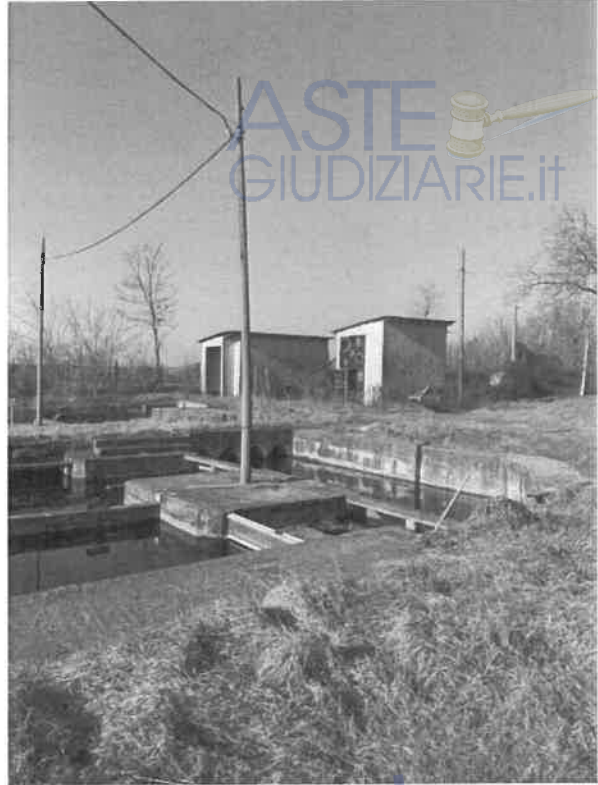
9- Manufatti per pompe
