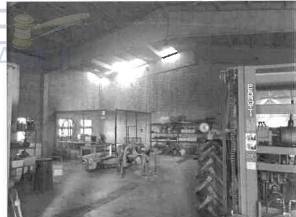
17- Copertura danneggiata del magazzino
