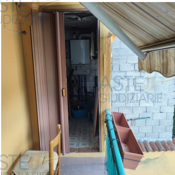
Fotografia n. 19– Locale caldaia esterno
