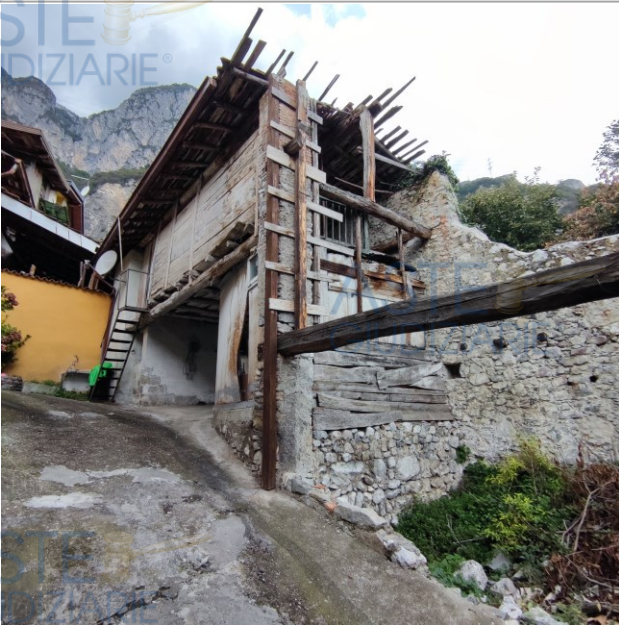
Fotografia n. 31- Corpo Esterno- Particolare Edificio Confinante Crollato
