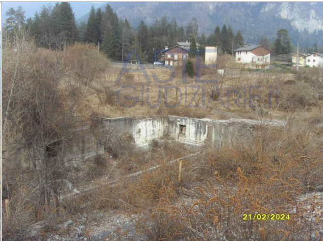
Fabbricato oggetto di demolizione non completamente demolito
