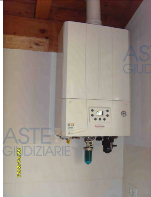
Caldaia interna – zona cottura
