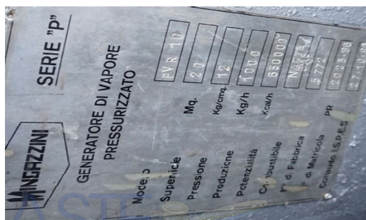
Foto 93- Etichetta caldaia C.T. n 1
