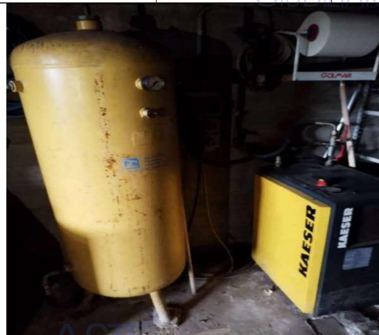
Foto 90- Compressore con quadro comando, serbatoio ed essiccatore
