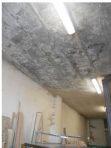
FOTO 5 ulteriore porzione di solaio di copertura con evidenti segni di ammaloramento dell'intonaco all'intradosso del solaio (area di circa 15 mq)
