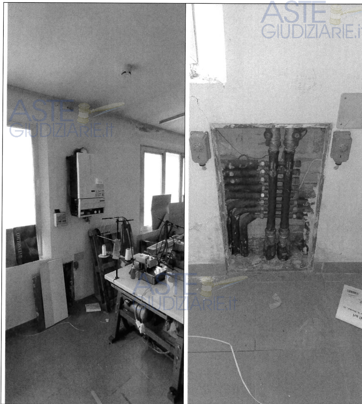
FOTO 12 e 13 – Parete corrispondente alle sottostanti infiltrazioni di Area 3.
