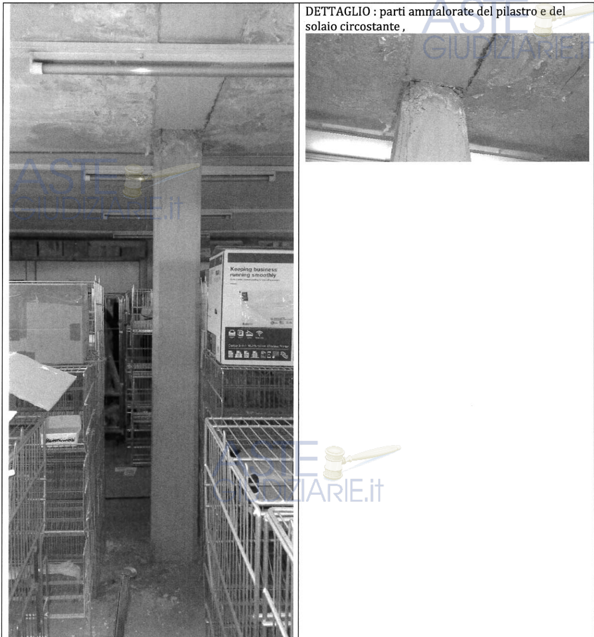
FOTO 2 E 3 - AREA 3 - sul pavimento distacchi di intonaco dal solaio e dalla sommità del pilastro.
