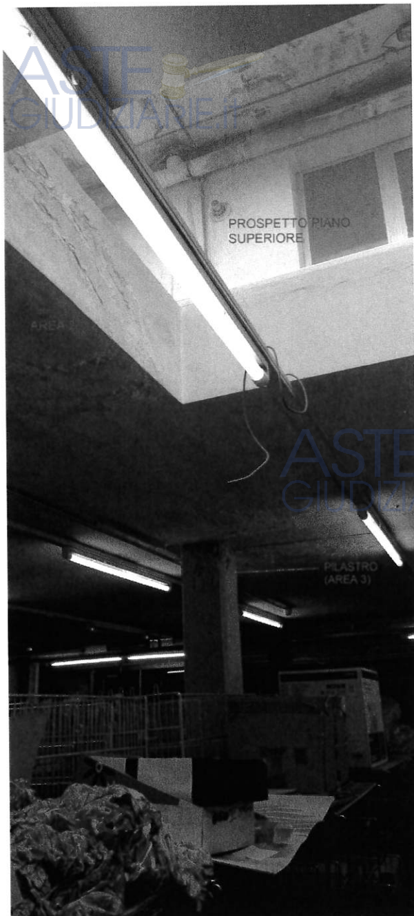
FOTO 11 - Corrispondenza delle infiltrazioni in Area 3 con il prospetto soprastante .
