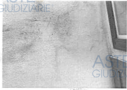
Foto 2: infiltrazione nel corridoio
