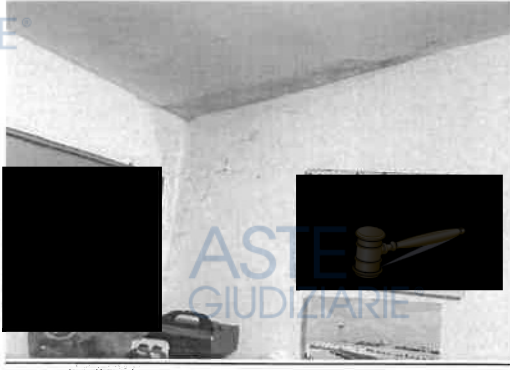
Foto 1: infiltrazione nella camera
