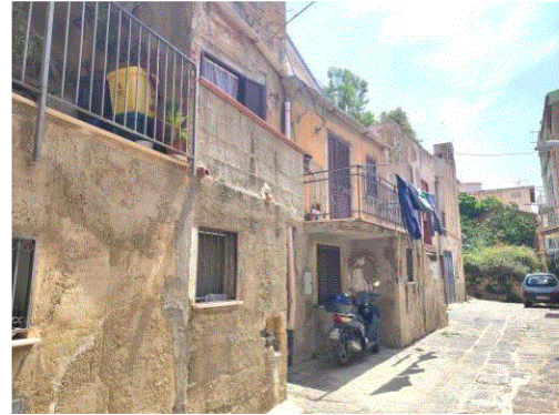
Foto 8 – Ingresso unità immobiliare oggetto di Esecuzione Immobiliare RG 203/2018 da vicolo San Francesco di Paola
